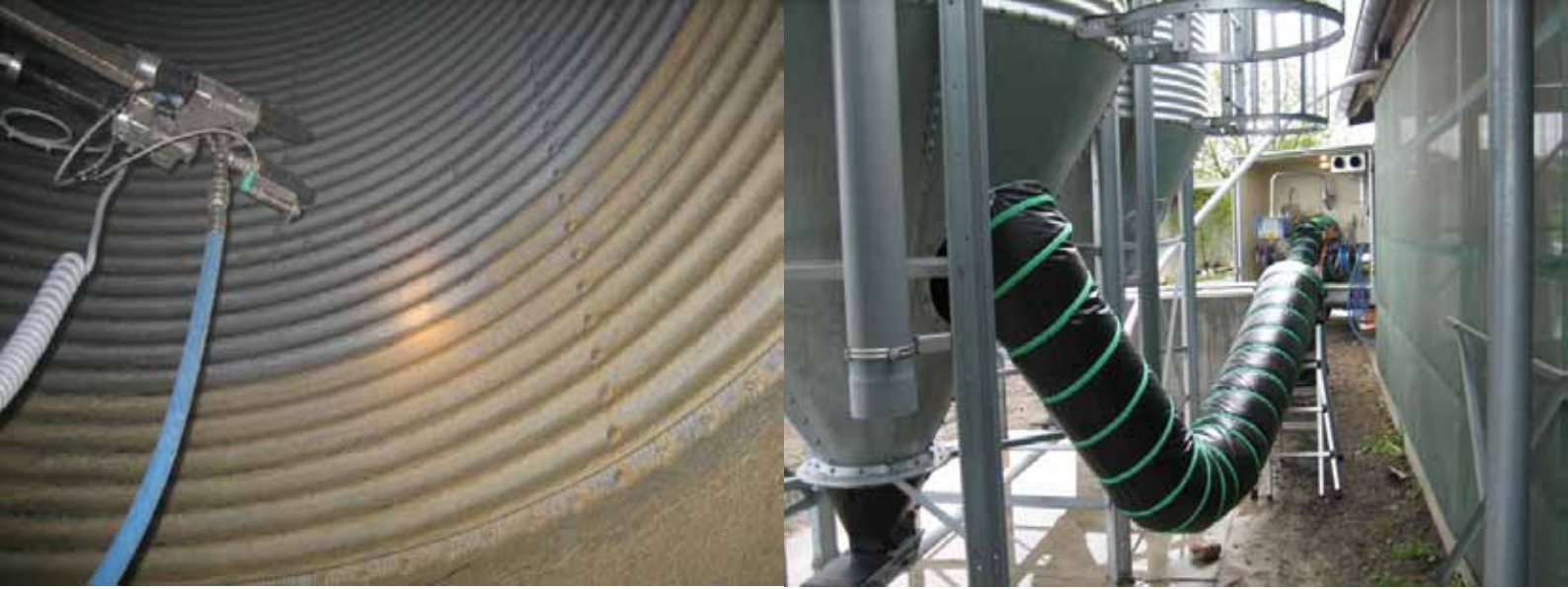
Abbildung 2: Siloreinigung mit dem Silo-RoBoFox. Eine fachliche Reinigung, Desinfektion und Trocknung wird von verschiedenen Unternehmen angeboten. (Quelle: LGZ www.guggisbergzimmerwald.ch )
